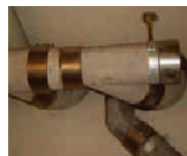
Rohrleitungen aus Asbestzement
