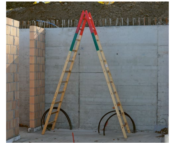
Beispiel einer Bockleiter, die obersten 2 Sprossen dürfen nicht betreten werden.
