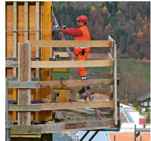
Beispiel einer zusätzlichen Massnahme bei erhöhter Absturzstelle (Seitenschutz)
